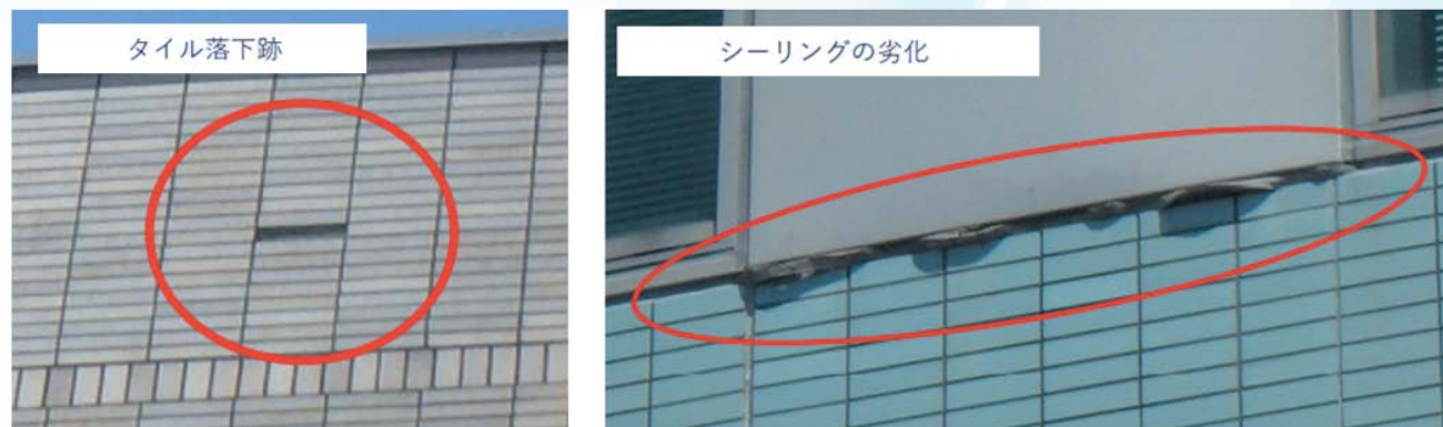
図表4-2 ●屋上防水・外壁の劣化状況②
